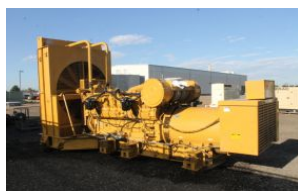
1750 KW Caterpillar 3516 DITA Diesel...
